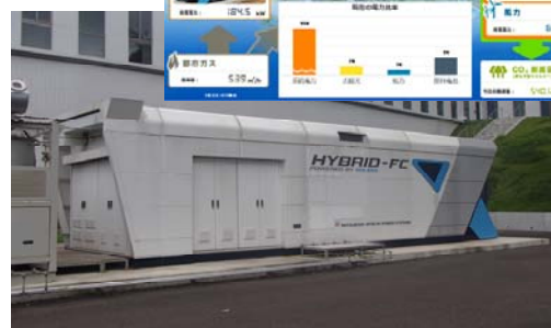
250kW 級 燃料電池発電設備
