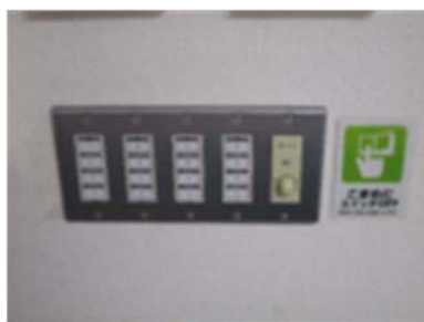
事務室照明スイッチ付近
